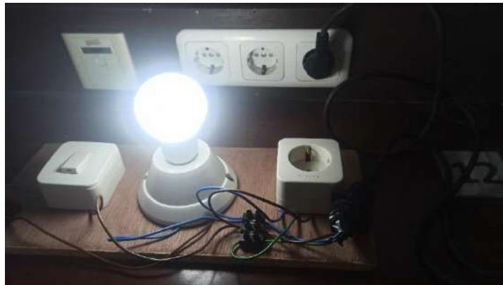
Lampiran 5. 2 Instalasi listrik
